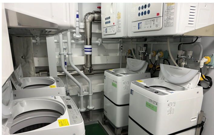
「いつくしま」の洗濯エリア
