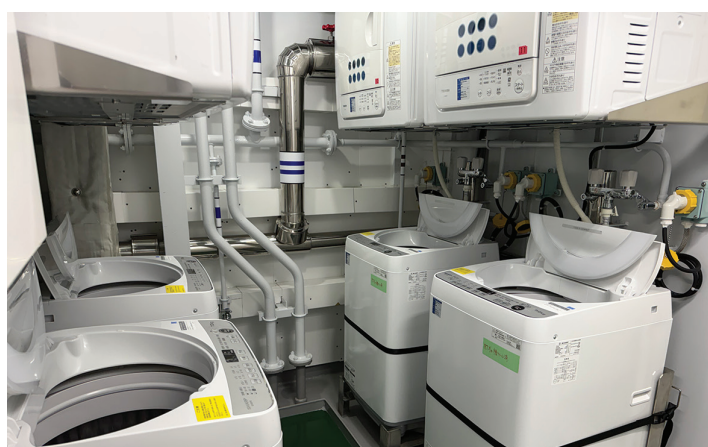
「いつくしま」の洗濯エリア
